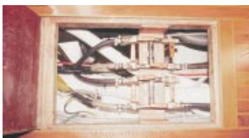
Unter den Bodenklappen werden die Ventile für die verschiedenen Tanks geschaltet
