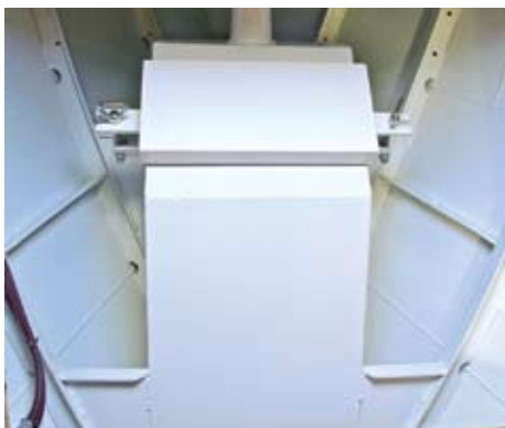
Der Kettenkasten in der Vorpiek ist über eine Serviceluke zugänglich
